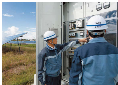
太陽光発電所における定期メンテナンスの様子
