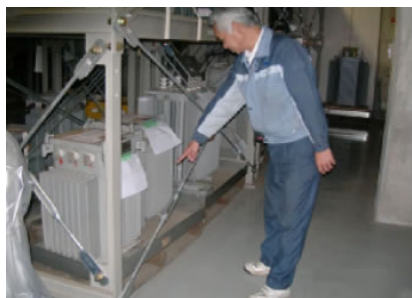
PCB含有機器類の適正保管・点検状況
