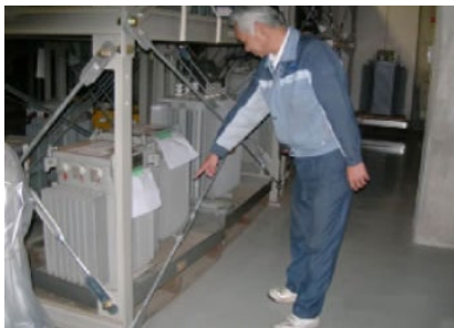
PCB含有機器類の適正保管・点検状況
